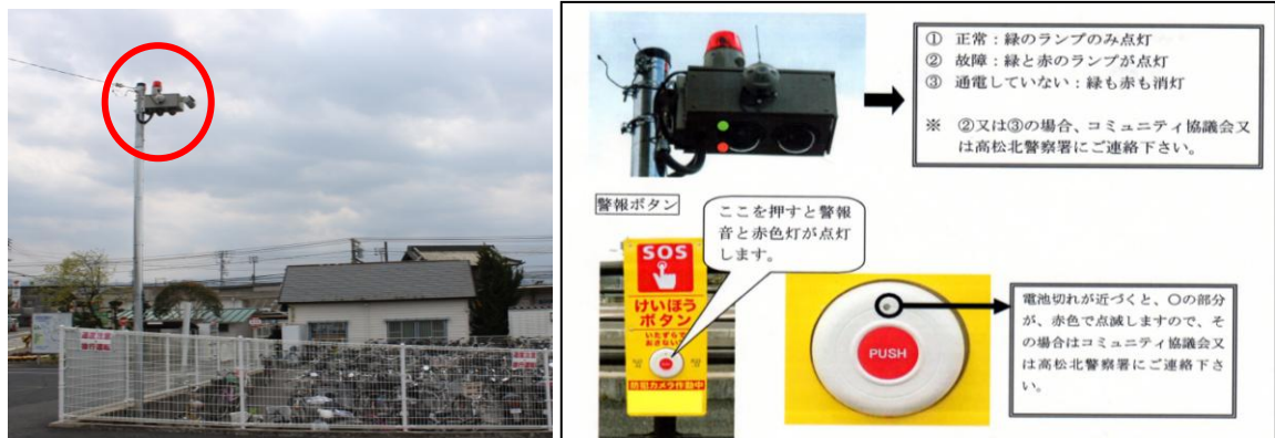
防犯カメラ監視システム
