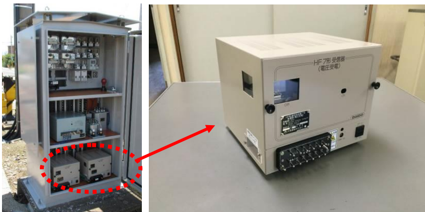
踏切制御機器の更新
