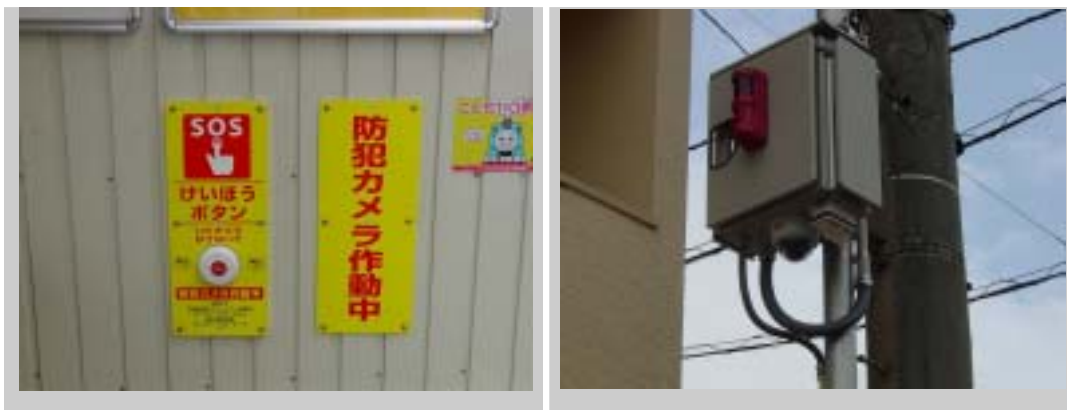
駅の防犯カメラシステム
