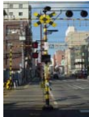
全方向踏切警報灯 2008/12
